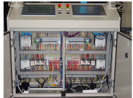
PUPITRE DE SUPERVISION AVEC L'AUTOMATISME DU MOBILE DE MANUTENTION
