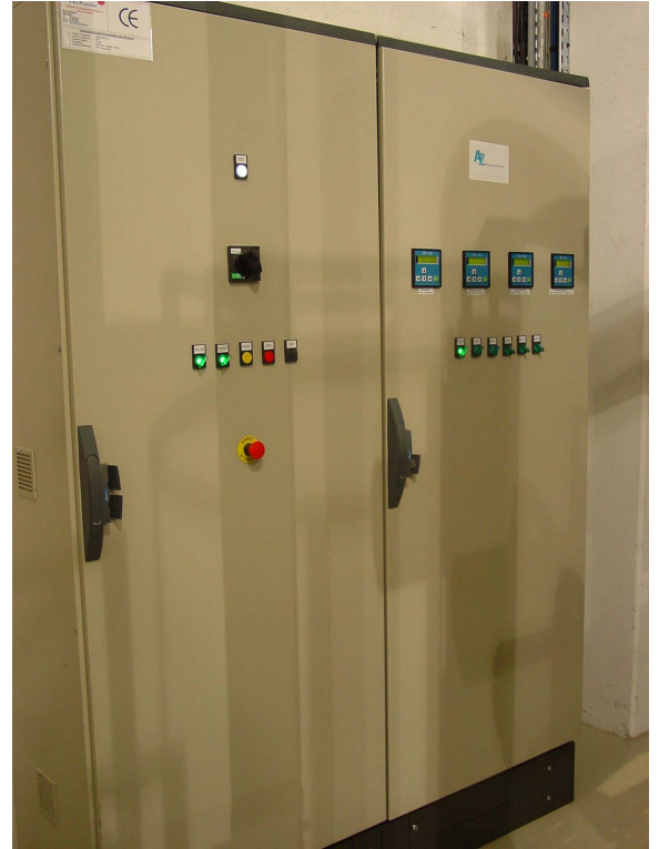
ARMOIRE GENERALE TRAITEMENT DES EAUX
