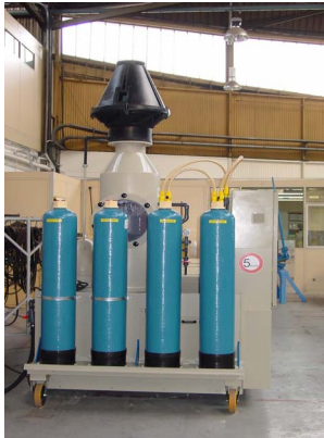
Installation mobile avec ses bouteilles anioniques et cationiques
