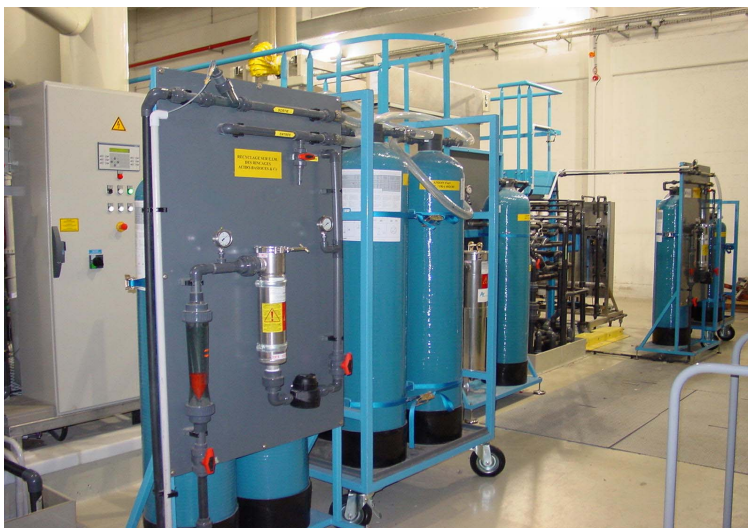
Installation de recyclage
